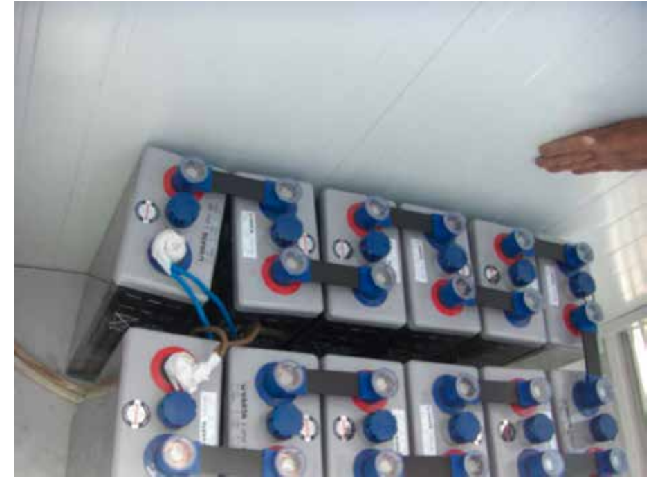
الشكل 3- البطاريات الجديدة التي تم تركيبها لكل نظام طاقة شمسية منزلي
