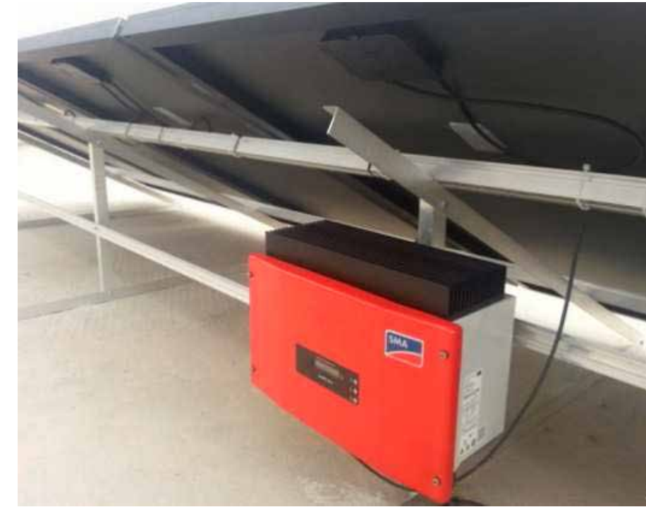
الشكل 14- محوّل عكس (منوب) لنظام متصل بالشبكة مثبت في الخارج
