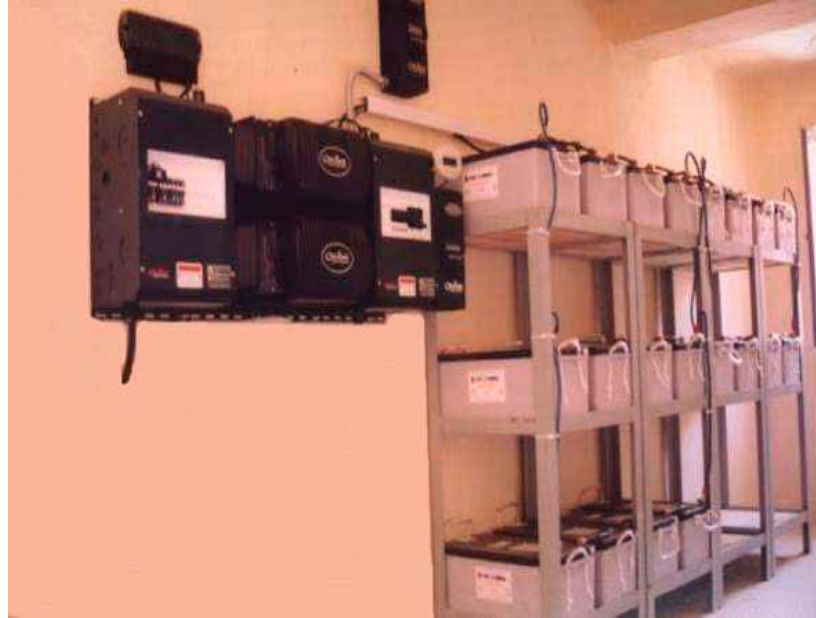
الشكل 7- البطاريات وغرفة التحكم
