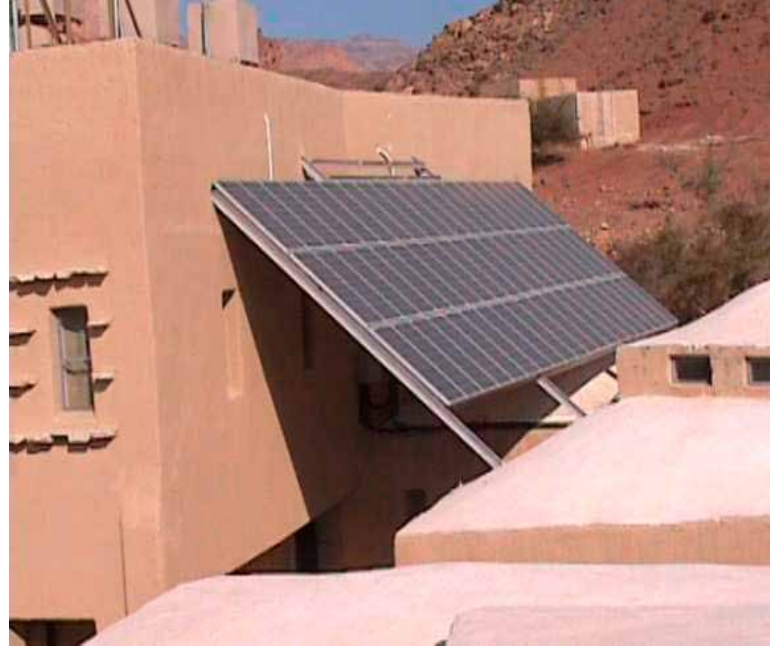
الشكل 5- نظام الخلايا الشمسية في المنزل بقدرة 4.5 كيلو واط. ذروة
