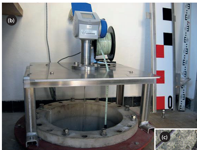
(b) Un capteur radar à ondes guidées installé dans un puits existant à Sète en France. (Photo SHOM).
