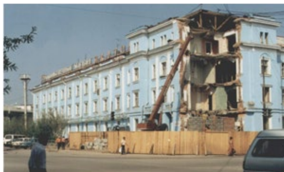
Рис. 2.8.11. Обрушение угла здания. Центр г. Якутск (Россия).
