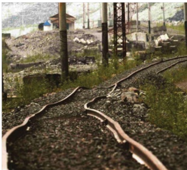
Рис. 2.8.8. Участок повреждённого железнодорожного пути.
